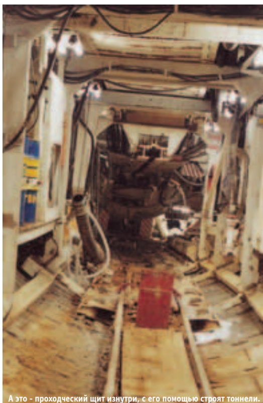
А это - проходческий щит изнутри, с его помощью строят тоннели.
